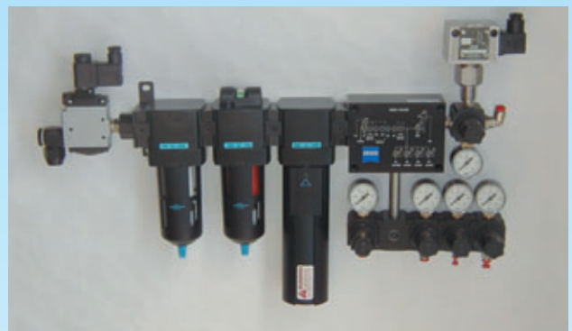
Luftaufbereitung einer Messmaschine mit feinstgefilterter und getrockneter Druckluft.
